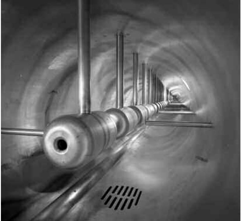
Tubes de dérive à l'intérieur d'un accélérateur linéaire, à Fermilab. Le faisceau est accéléré le long de l'axe central des structures.
